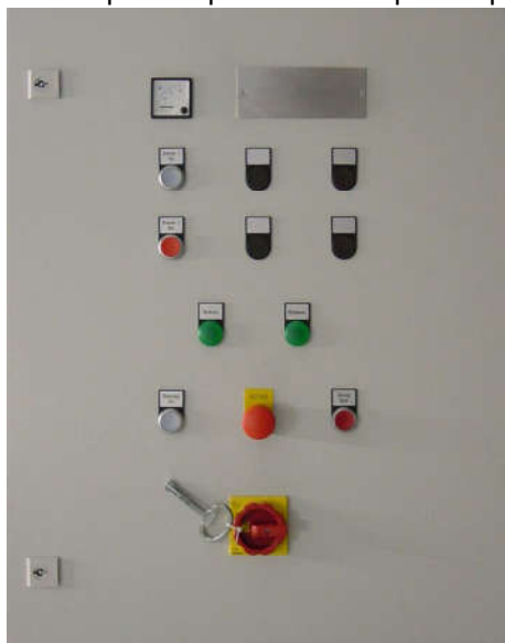
Контроль горелки в электрошкафу
